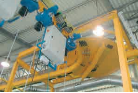
SinglePowerLine 0812 dans une installation de galvanisation avec aiguillages et un double collecteur de courant
