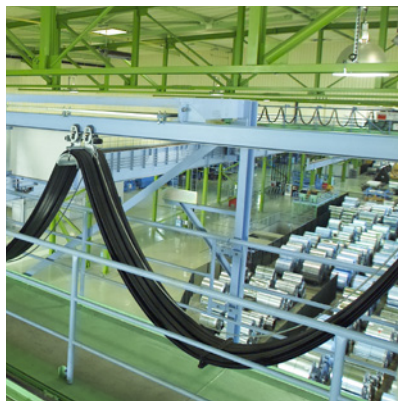
Alimentation puissance et commande sur un pont en acier
