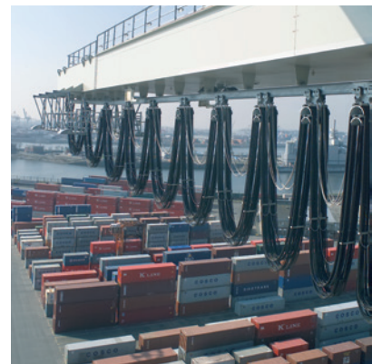
Alimentation du treuil sur un portique rapide à containers
