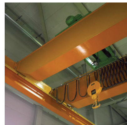
Alimentation d'un palan sur un pont roulant
