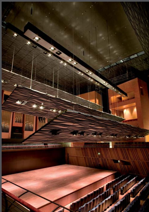
Quand puissance rime avec silence : Plafonds lumineux suspendus dans un auditorium philharmonique.
